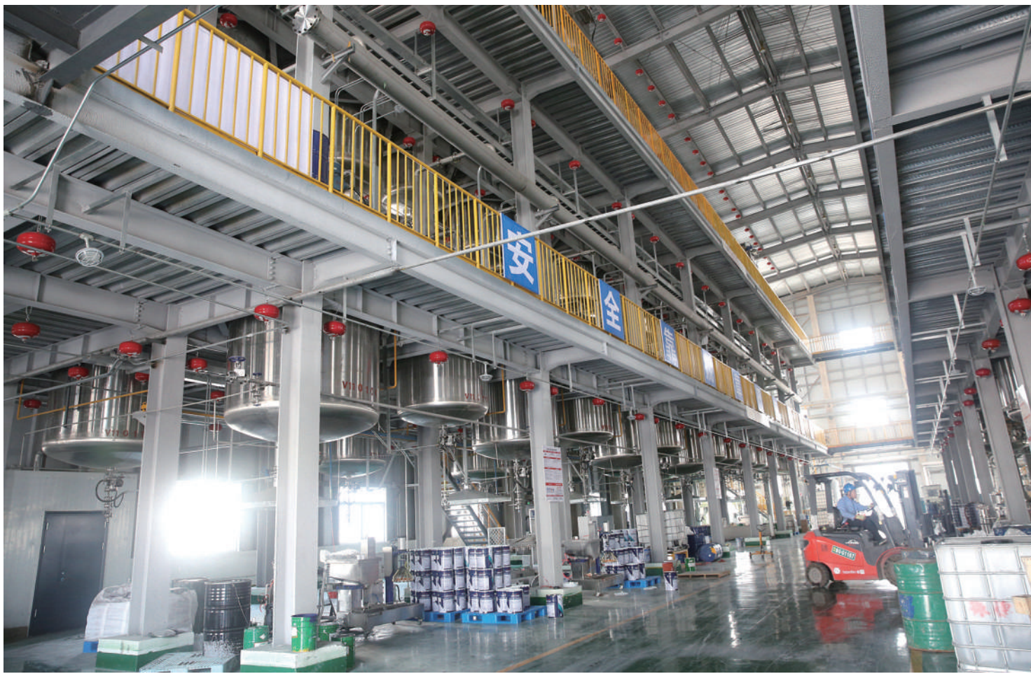
孚日股份生产园区内串联起“家纺+新材料”业务的管线
