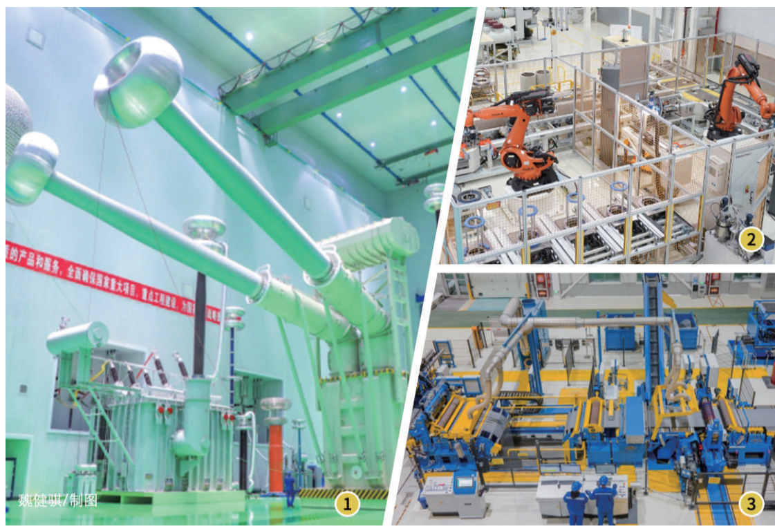
图①昌吉-古泉(准东-皖南)±1100kV特高压直流输电工程研制的国内首台发送端±1100kV换流变压器试制成功 图②特变电工云集科技产业园CT智能装配工作岛 图③公司机器人自动装嵌纵剪线 (公司供图)
