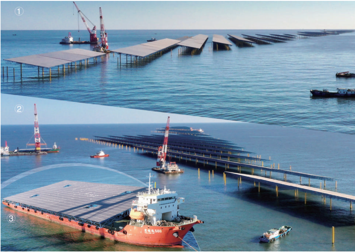
图①②河北华电昌黎海上光伏试点项目
