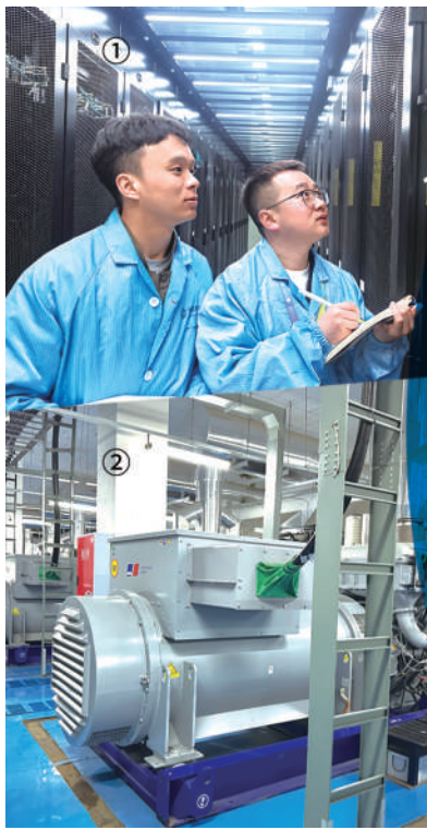
图①运维人员在数据机房巡检
