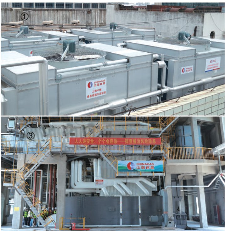
图①中国燃气上海东方大厦封闭式能源塔热泵项目
